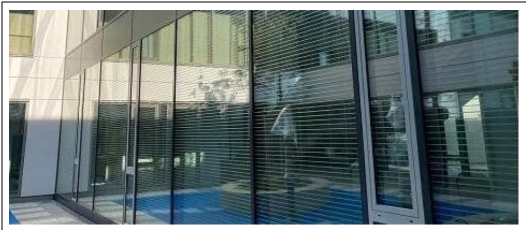
Abb. 5: Glasschutzfolie an der Außenseite eines Gebäudes auf dem Schulcampus in Unterföhring.
